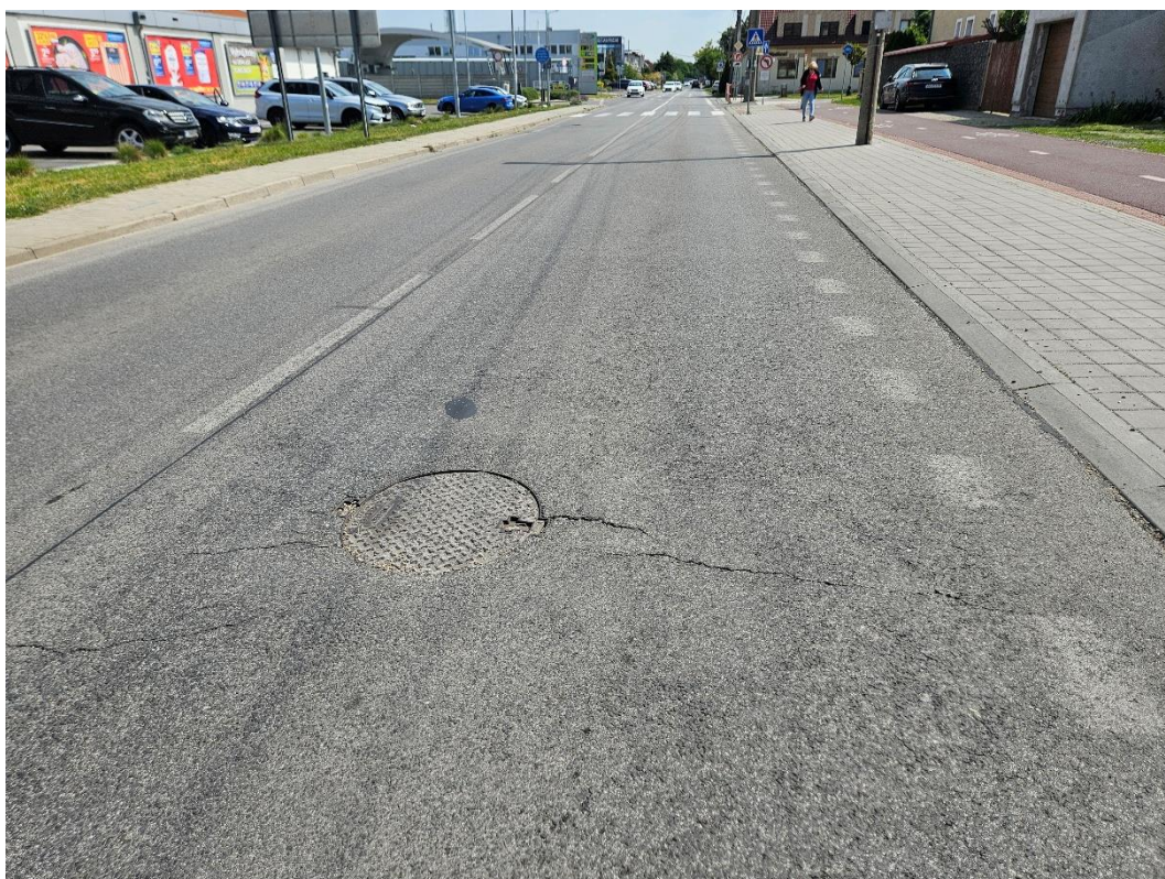
Obrázok 6 – Trhlina vyvolaná objektom vo vozovke
