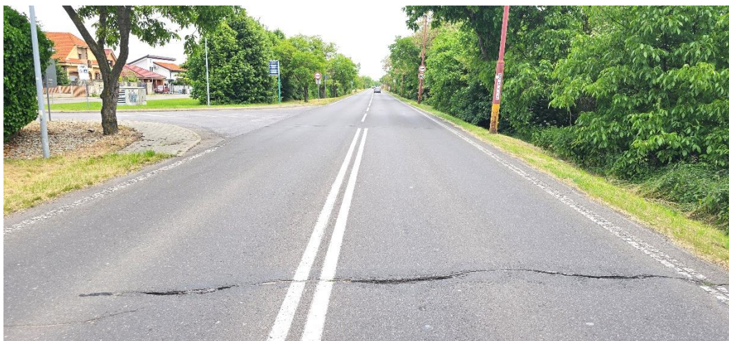
Obrázok 1 – Reflexná trhlina v kombinácii s trvalými deformáciami vo vozovke
