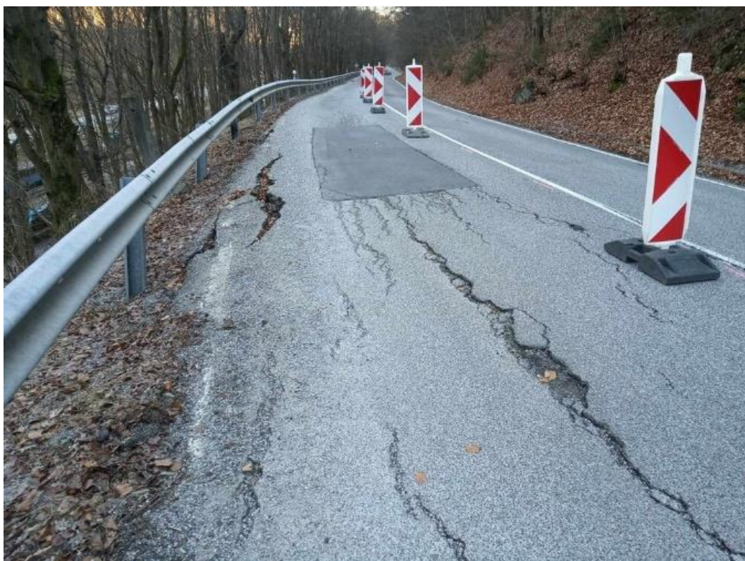
Obrázok 7 – Trhliny zapríčinené poruchou podložia
